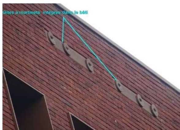
Figure 2 : Gîtes à martinets noirs intégrés dans un bâtiment neuf dans le quartier de Bois Blanc ©Florian Fournier
