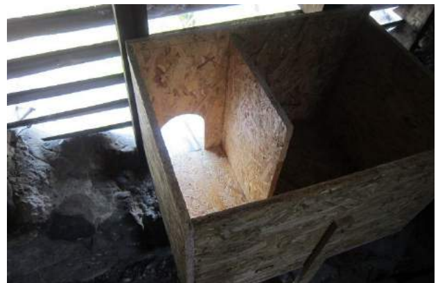
Fig. X / Pose d'un nichoir à chouette effraie dans la clocher de l'église du Bourg ©Ville de La Motte-Servolex
