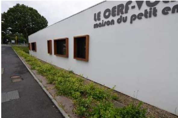
Figure 17. Géotextile plastique devant la maison du petit enfant résultant d'une erreur de conception
