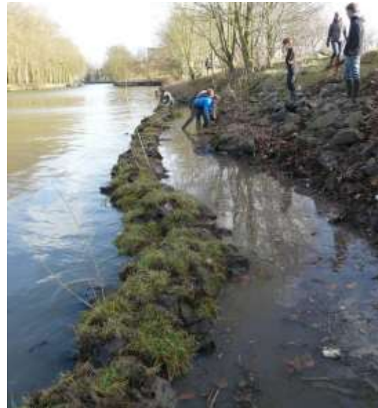
Figure 19: chantier de renaturation de berge sur le secteur des pyramides ©Ville de Lille
